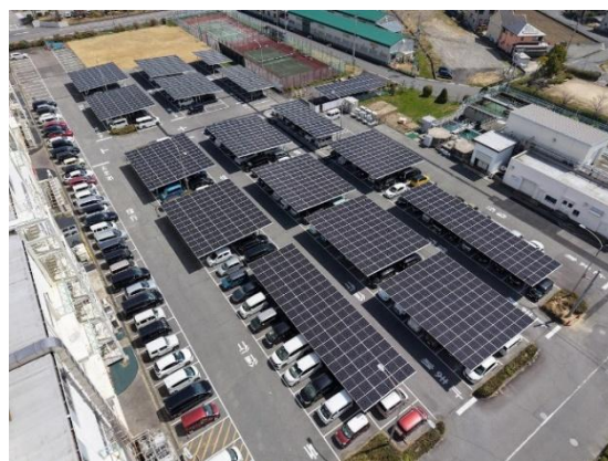
今回設置したカーポート型太陽光発電設備
